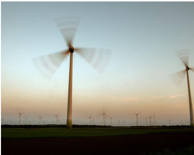
Windkraftanlage in Betrieb Foto © BKA / Andy Wenzel
