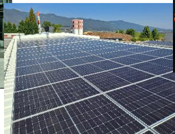
Foto: HBT Energietechnik
